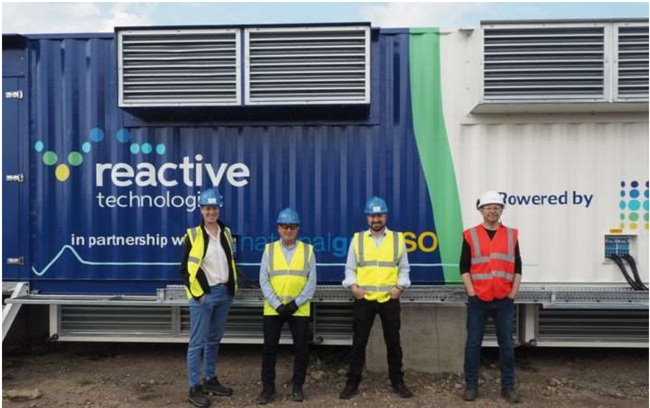
National Grid UK:n verkkoon asennettava Reactive Technologiesin GridMetrix-superkondensaattori
